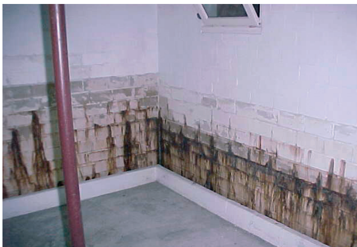
Vochtplekken in een kelder
